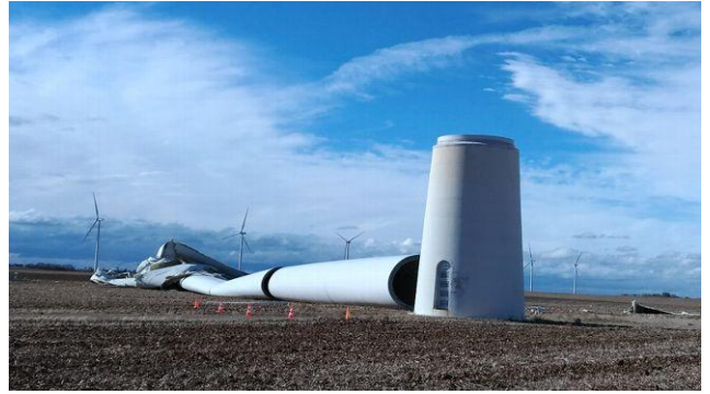
Nuit du 5 au 6/11/2018: Effondrement d'une éolienne dans le Loiret.
